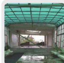
二樓連通走廊採光罩改善前
